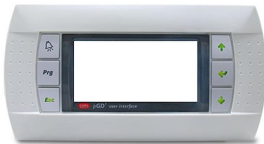
Figura 3.1. Painel de controlo.
